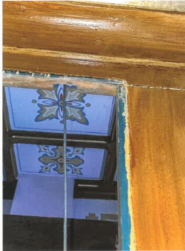
Fotografia nr 12 – Detal, widoczna wcześniejsza kolorystyka (autor – MPP, 2024 r.)
