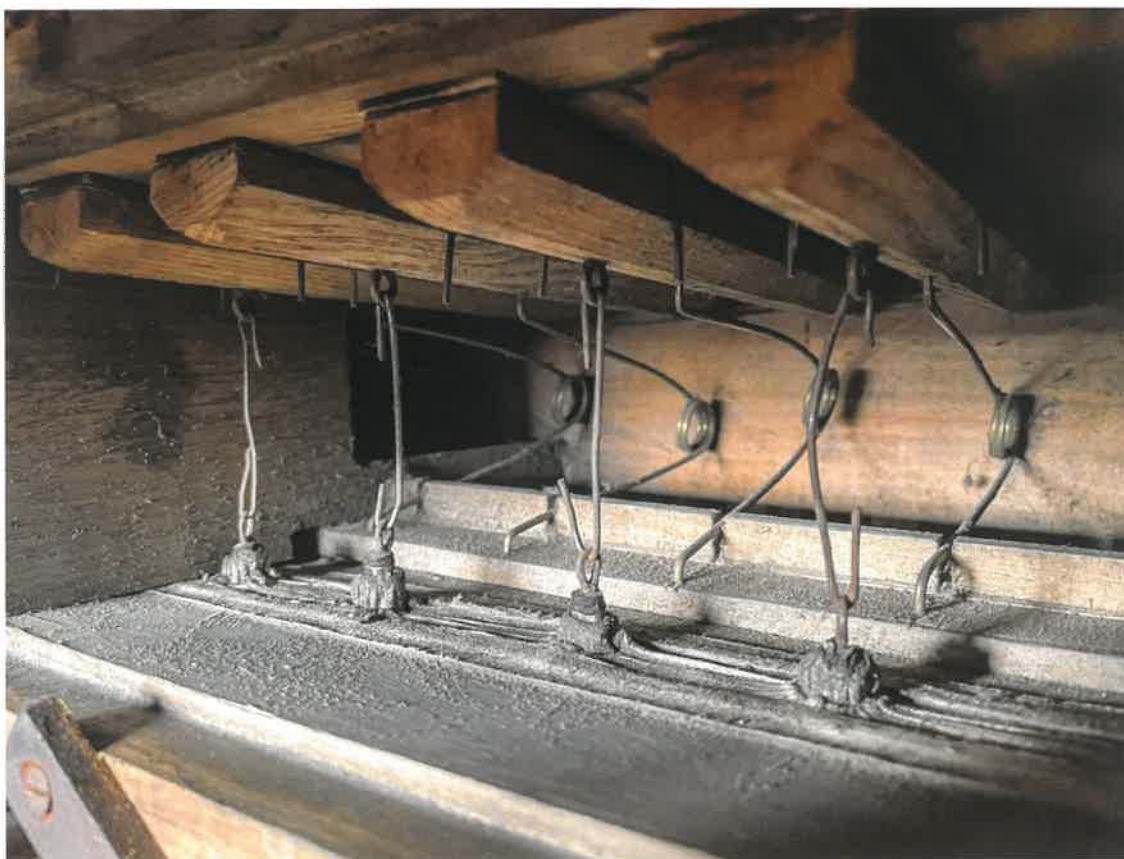
Fotografia nr 22 – Wnętrze komory wiatrowej wiatrownicy, pulpety, sprężyny, listwa dolna oraz podwójnie skórowane kłapy z podwójnymi sztyftami stabilizującymi (autor – FP, 2024 r.)
