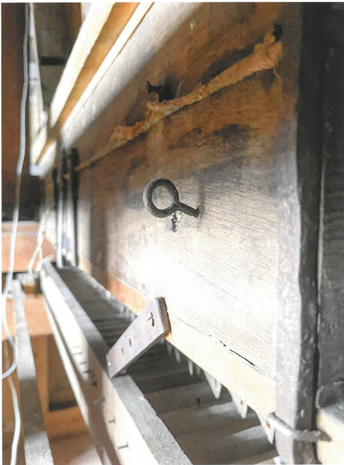
Fotografia nr 23 – Dekiel dostępowy wiatrownicy z uszczelniającym metalowym zamknięciem (autor – FP, 2024 r.)
