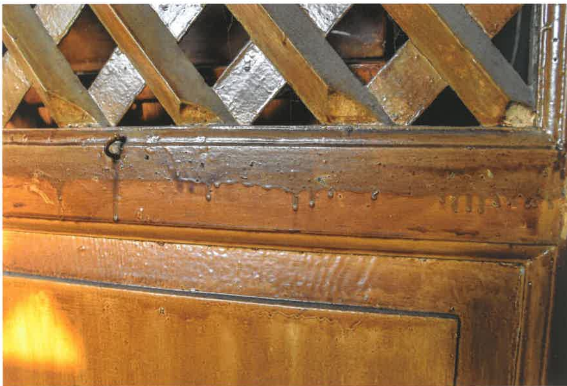
Fotografia nr 9 – Detal, widoczne zacieki farby (autor – MPP, 2024 r.)
