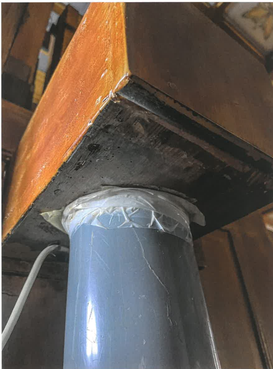
Fotografia nr 28 – Sposób połączenia oryginalnego drewnianego kanału wiatrowego z wtórnice zainstalowaną rurą kanalizacyjną uszczelnioną taśmą klejącą (autor – FP, 2024 r.)
