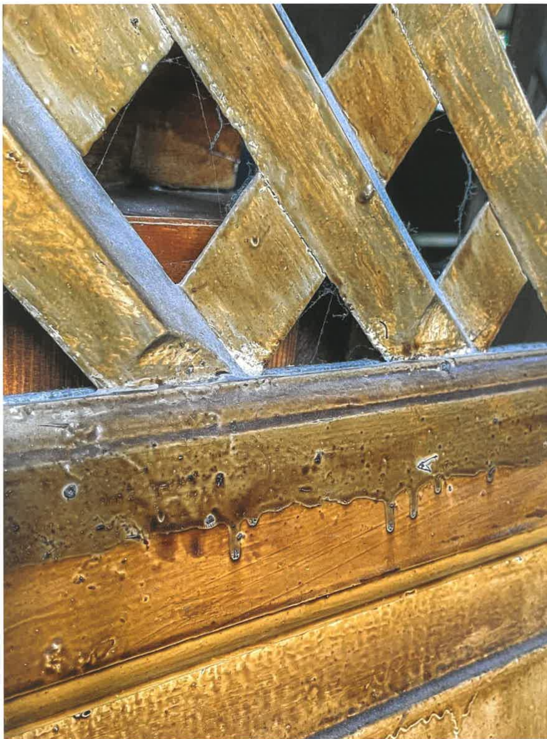
Fotografia nr 11 – Detal, widoczne zacieki farby (autor – MPP, 2024 r.)
