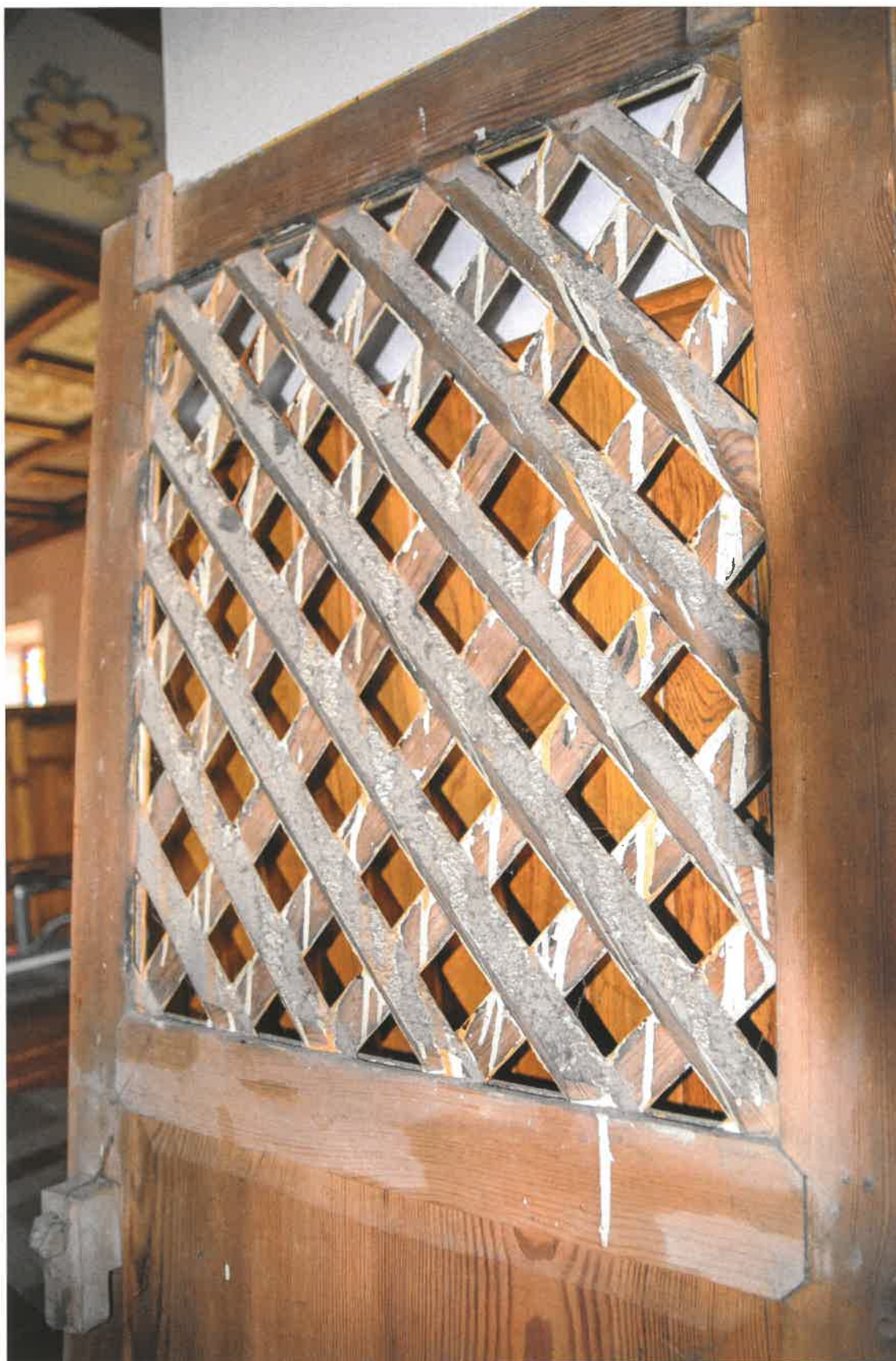
Fotografia nr 15 – Zdemontowane boczne drzwi dostępne, widoczne zacieki (autor – MPP, 2024 r.)
