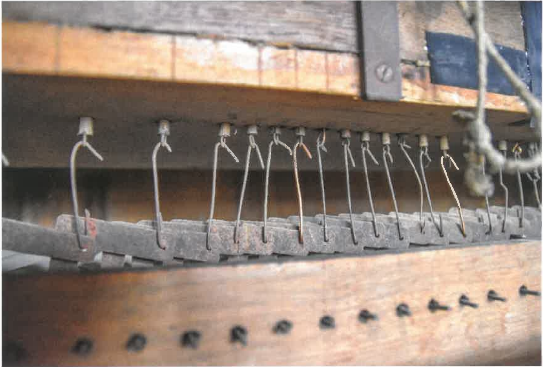
Fotografia nr 25 – Połączenie traktury gry z wiatrownicą, metalowe kątowniki połączone za pomocą drutów do metalowych oczek pulpetów (autor – FP, 2024 r.)
