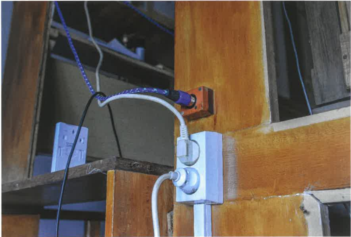
Fotografia nr 16 – Elementy instalacji elektrycznej (autor – MPP, 2024 r.)
