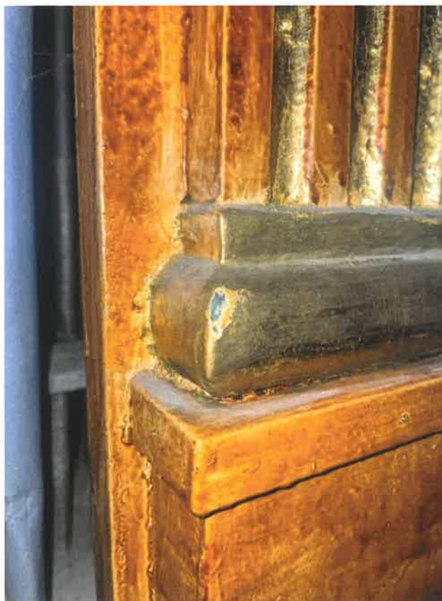
Fotografia nr 7 – Detal, widoczny ubytek ukazujący wcześniejsze nawarstwienia (autor – MPP, 2024 r.)
