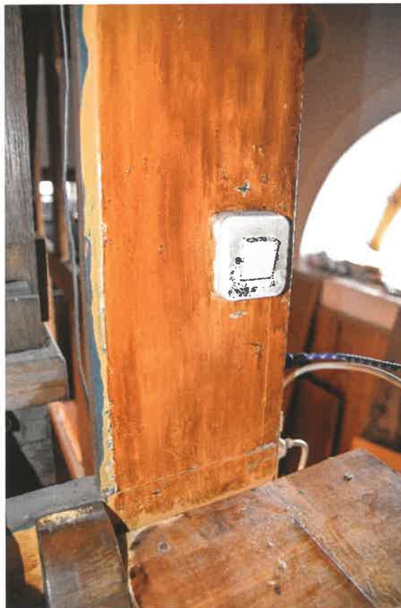
Fotografia nr 13 – Detal, widoczne elementy instalacji elektrycznej (autor – MPP, 2024 r.)
